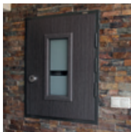
Ochrana elektroměru, bezpečnostní třída 3
