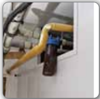
Přizpůsobení rozvodům ve sklepě
